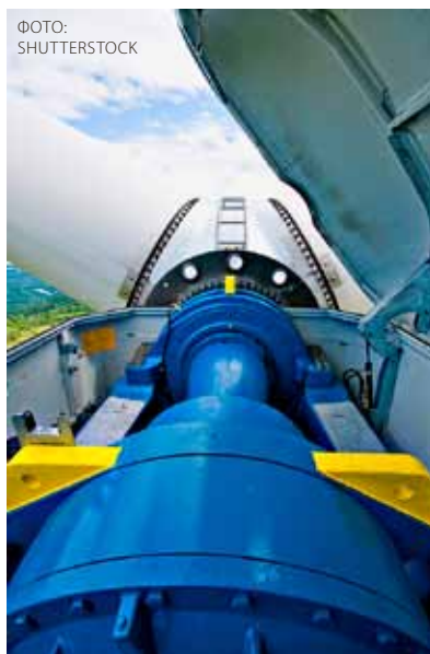
Силовая передача ветроэнергетической установки, вид с гондолы ветровой турбины.
