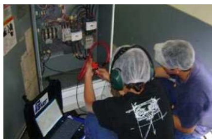
Prüfung der Leistung eines Elektromotors mit dem SKF Dynamic Motor Analyzer
