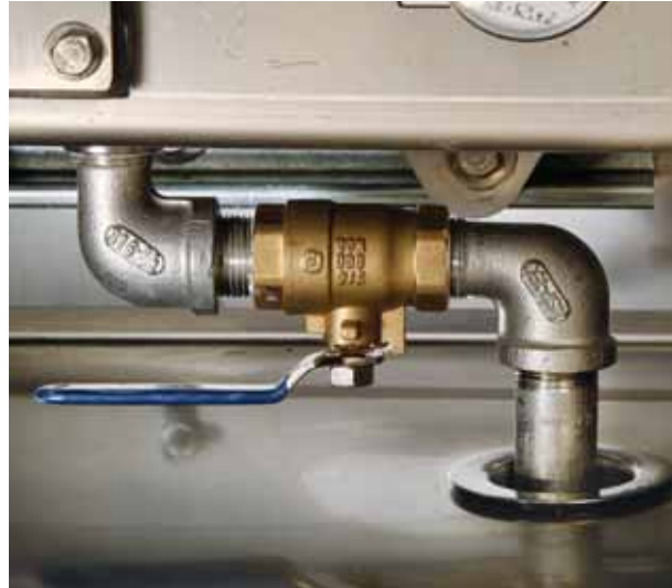
Şek. 19 Rezervuar Boşaltma Valfi ve Mahfaza Boşaltma Portu
