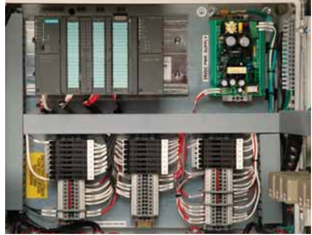
Şek. 05 Programlanabilir Akıllı Kontrolörü (PLC) ve Elektronik Kısımlar
